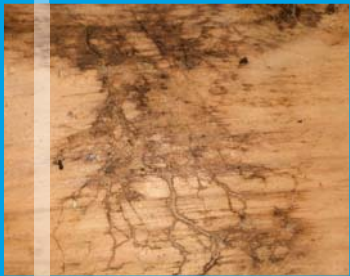
Zerstörerische Wirkung: Diese Fußbodendiele zeigt sichtbare Reste eines Holz zerstörenden Pilzes und einen gering ausgeprägten Schimmelpilzbefall.
