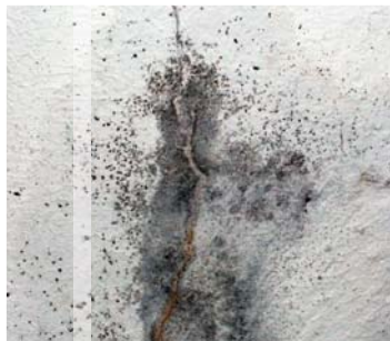
Schwarz auf weiß: Feuchte Wände und Pilzbefall können die Bausubstanz schwer schädigen. Schwarzsimmel wächst auch bei niedrigen Temperaturen.
