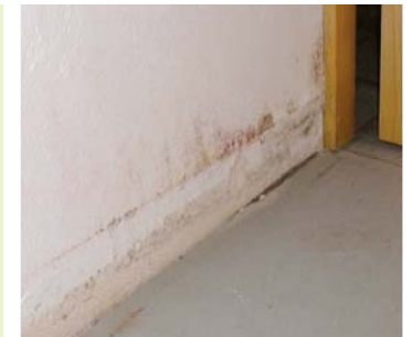
Sichtbare Schäden: Bräunlich roter Schimmelbefall an einer Kellerwand nach einem Wasserschaden
